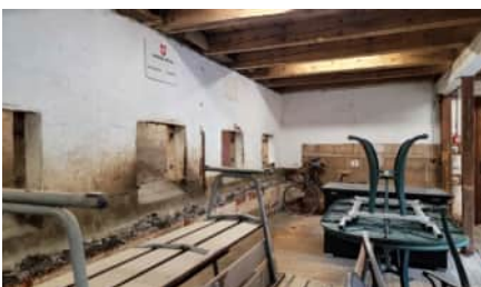
Der frühere Viehstall wurde als Abstellraum (Bild) genutzt, neu dient er als Veloraum.
